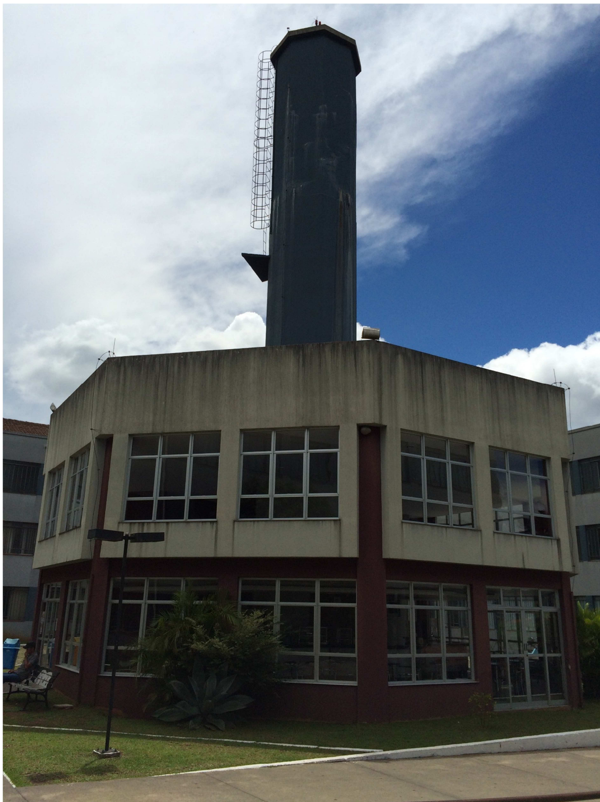
(Eflorescência na área externa)
