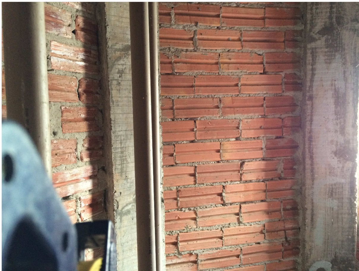
(Paredes internas sem proteção)
