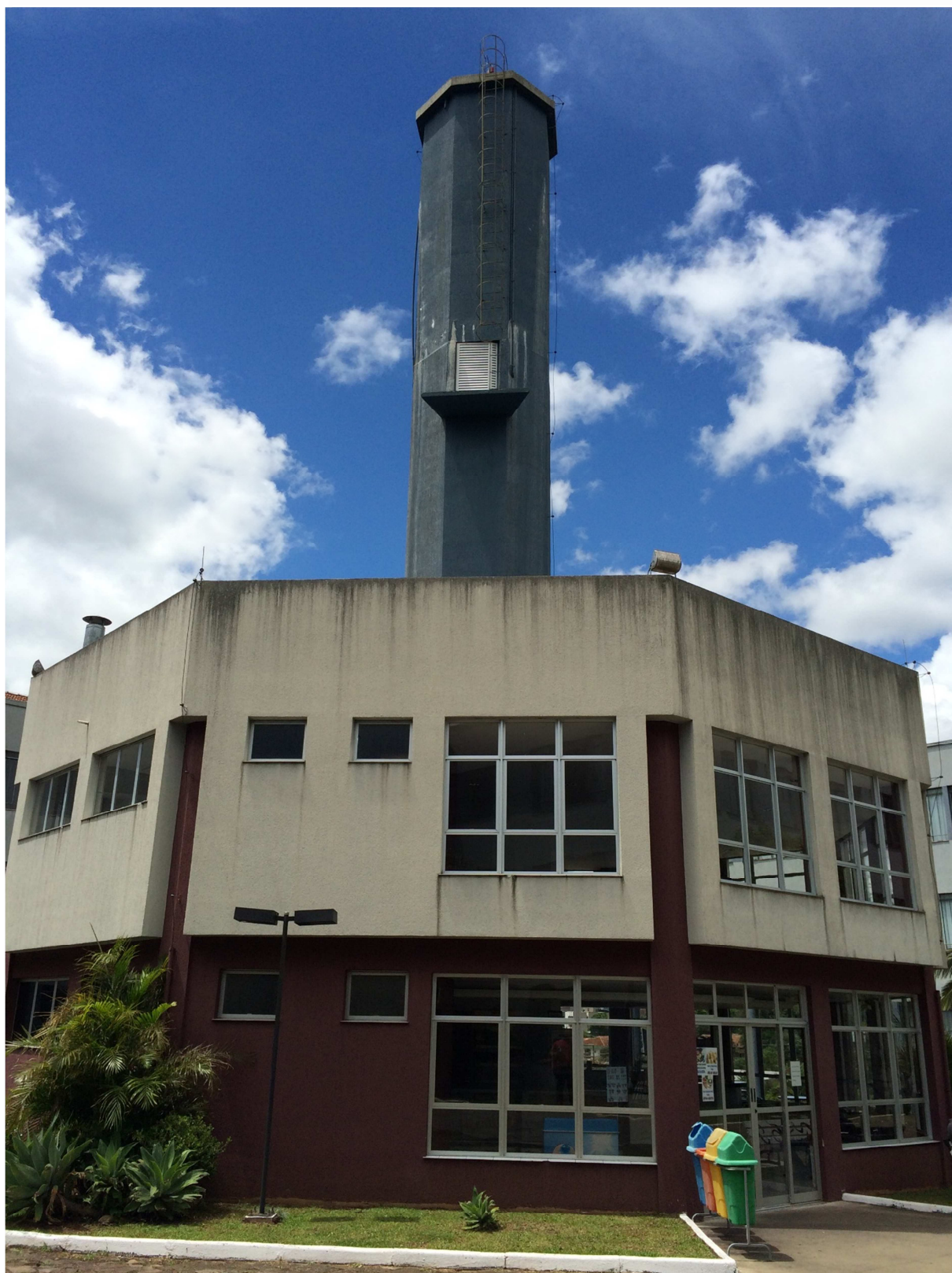
(Eflorescência na área externa)
