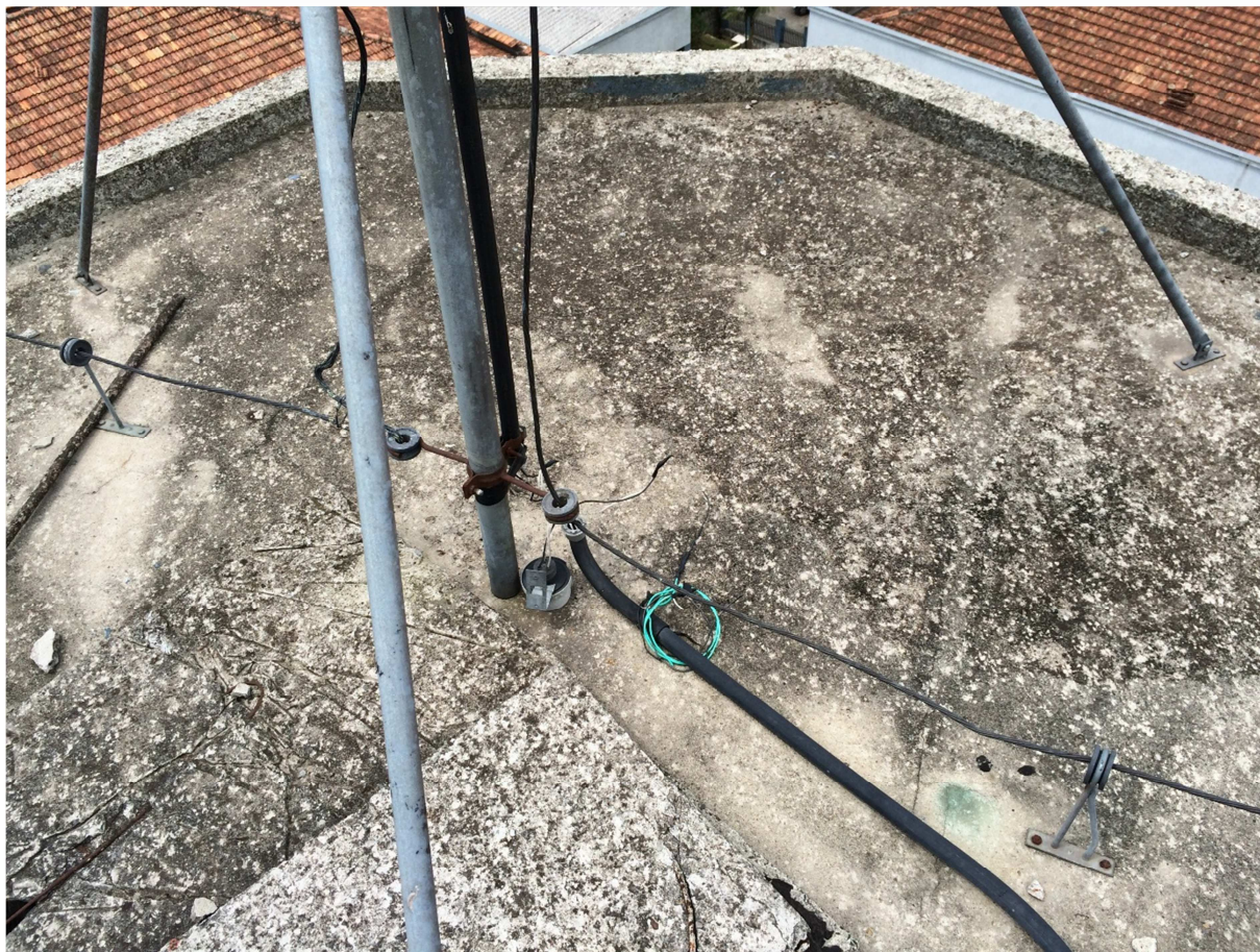
(Topo da caixa d'água sem proteção)
